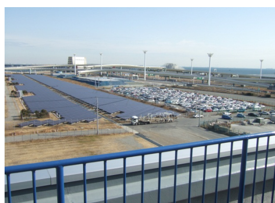
屋外のスペースに設置された太陽光パネル
